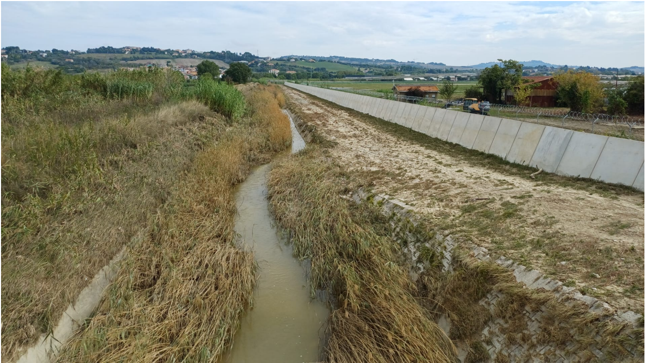
Figura 36: Stazione di Fiumesino in data 23 settembre 2024. Traccia dell'onda di piena verso monte.
