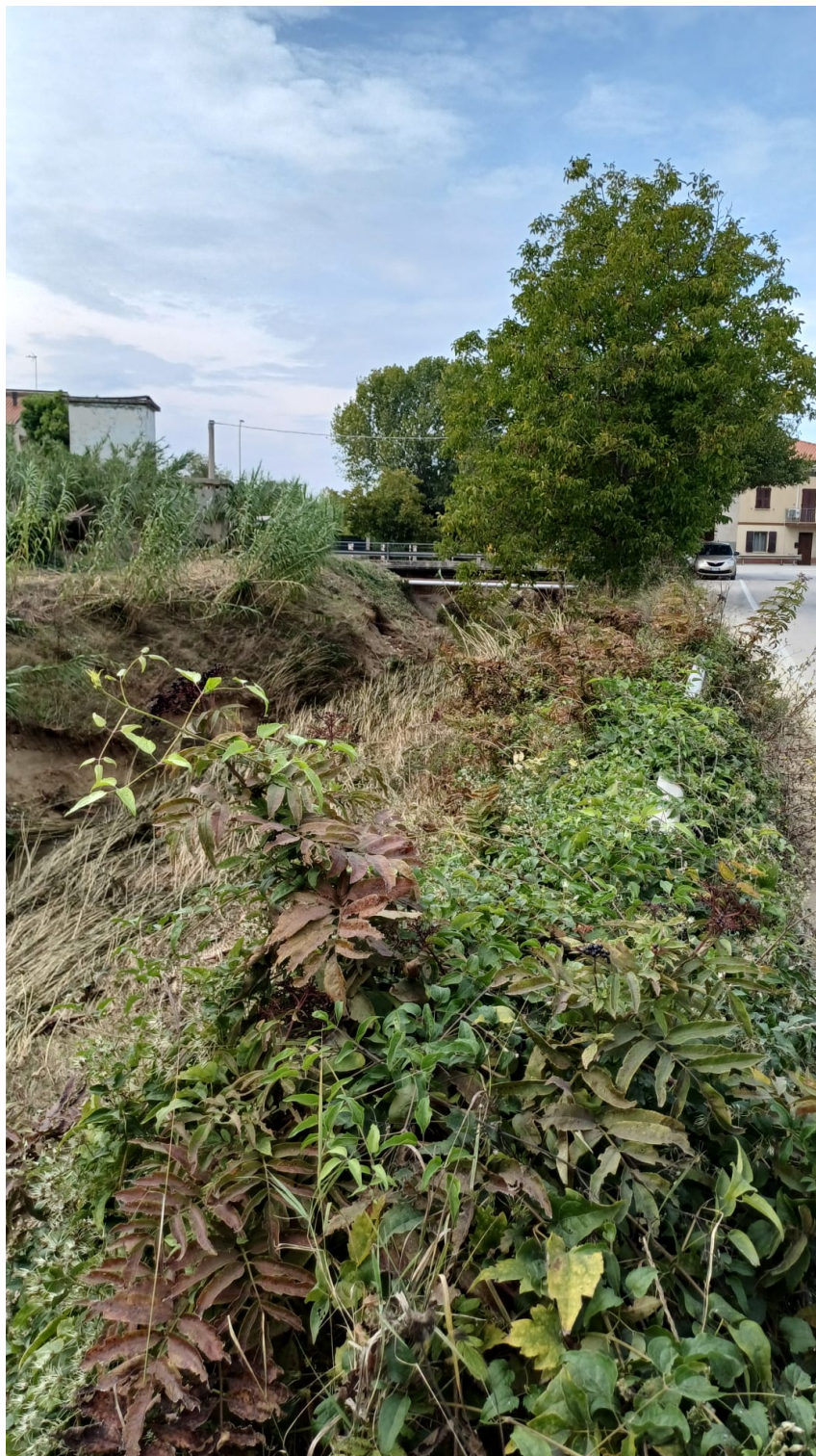
Figura 33: Castelferretti Fosso San Sebastiano - 23 settembre 2024.
