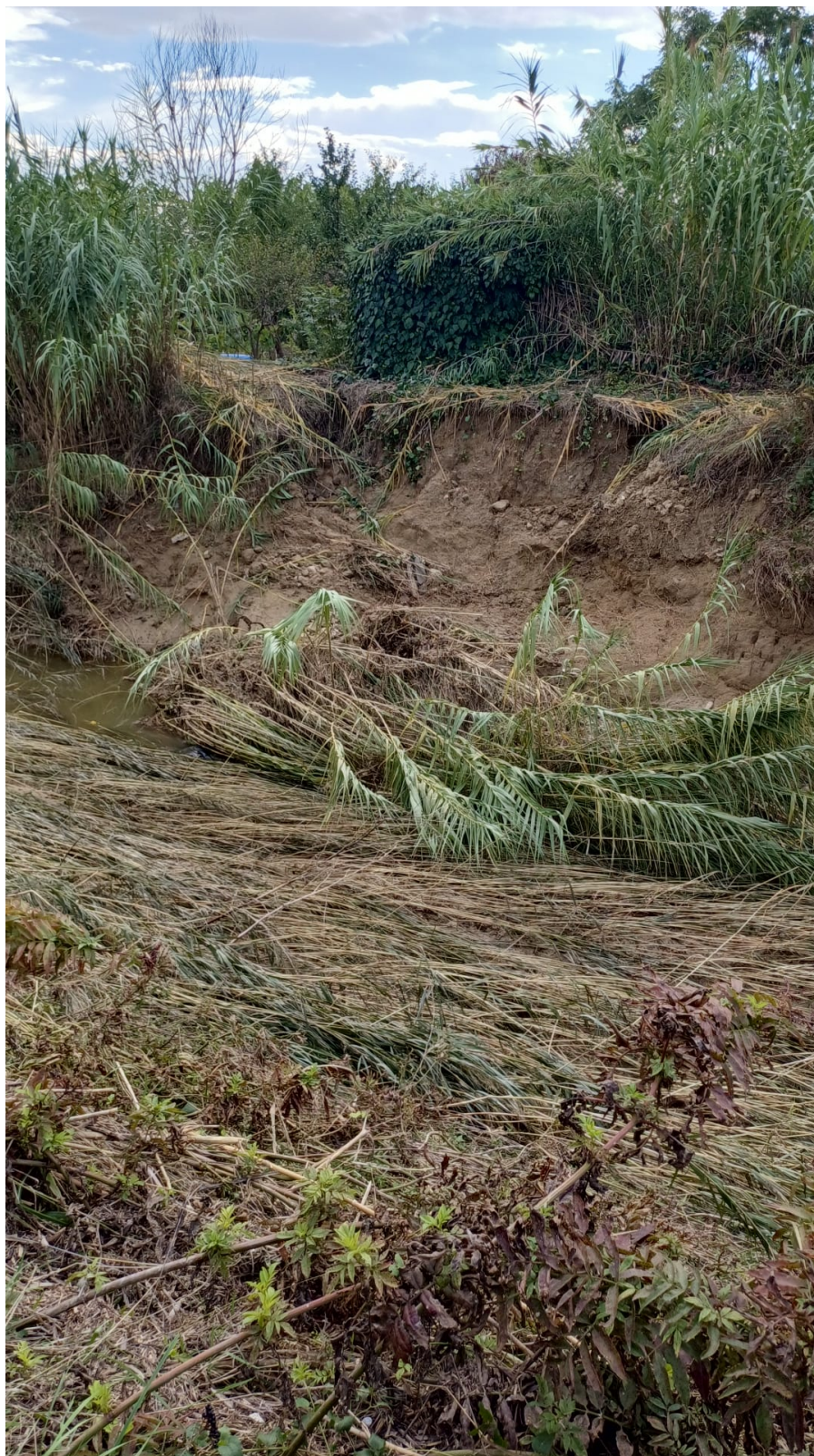
Figura 34: Castelferretti Fosso San Sebastiano cedimento spondale - 23 settembre 2024.
