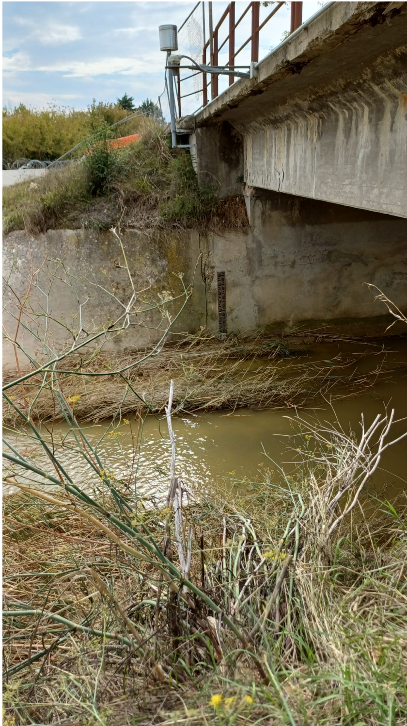
Figura 35: Stazione di Fiumesino in data 23 settembre 2024. Traccia dell'onda di piena sino all'impalcato del ponte.
